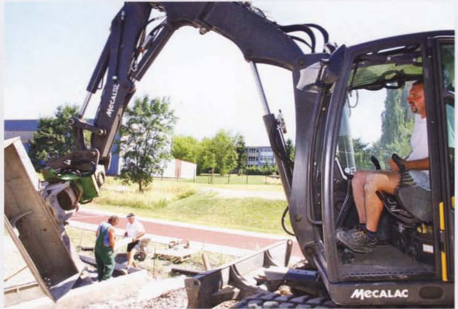
Beim Bau der Sportanlage hat sich der Mecalac 8MCR auf Gummiketten unentbehrlich gemacht.
