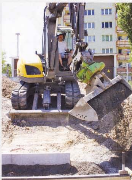
Gezielt kann mit der dreh- und schwenkbaren Schaufel Material in die engen Ausschachtungen für die Sprunggrube bequem von oben verfüllt werden.
